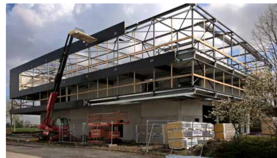
De grote bouwvolumes zorgden ervoor dat er niet al te veel plaats overbleef voor de werkzaamheden op de werf.
